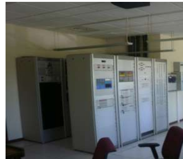
Avant rénovation du SSI :
