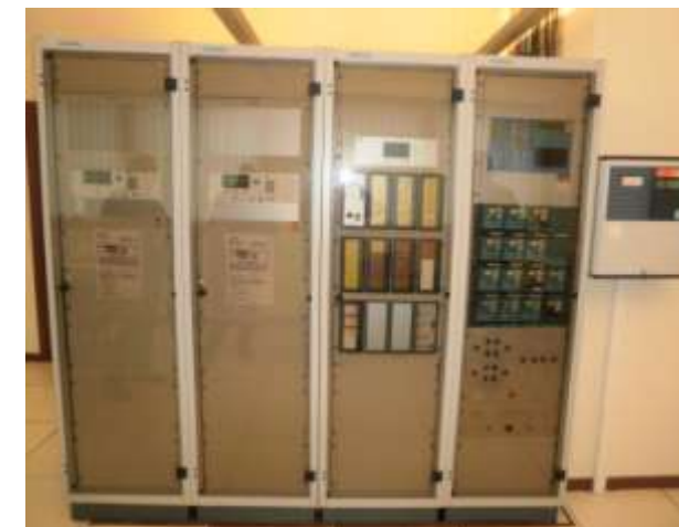
Après rénovation du SSI :
